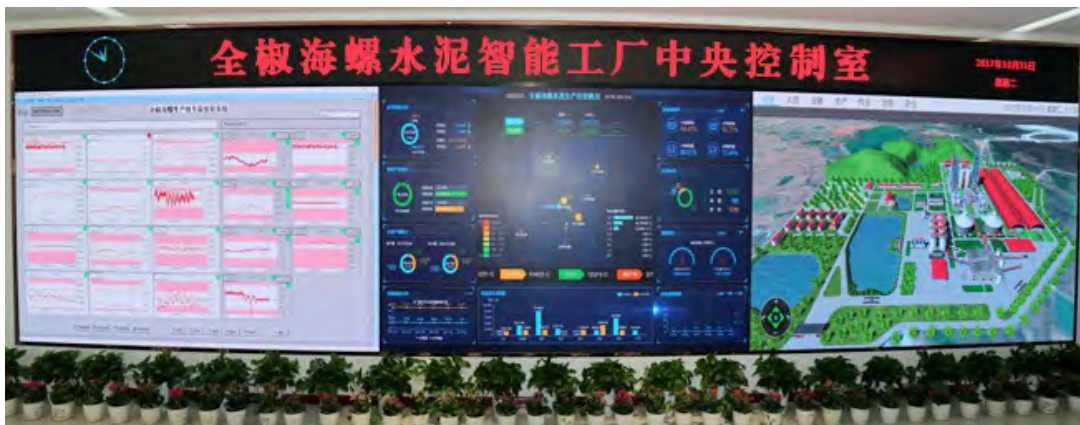
图6 专家自动操作系统—中央控制室
